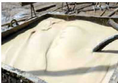
Tanque de preparação
